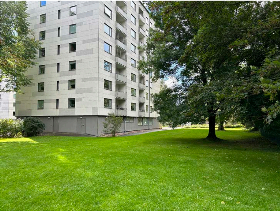
Höjdsättning som innebär risk för översvämning i vissa delar av fastighetsbeståndet
